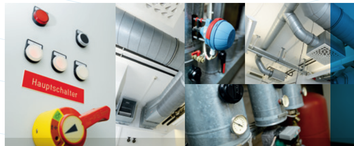
KLIMA- UND LÜFTUNGSTECHNIK IN DEN TECHNIK- UND LABORRÄUMEN
