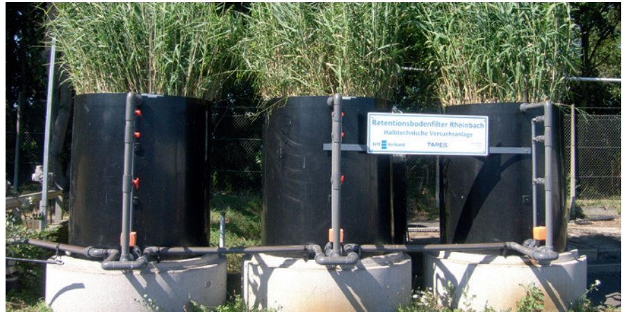
Versuchsanlage Retentionsbodenfilter Rheinbach
